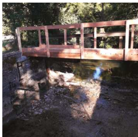
Figure 8.1 : « suite à la suppression des vannages le 15 septembre 2018 il reste un mince filet d'eau ».
